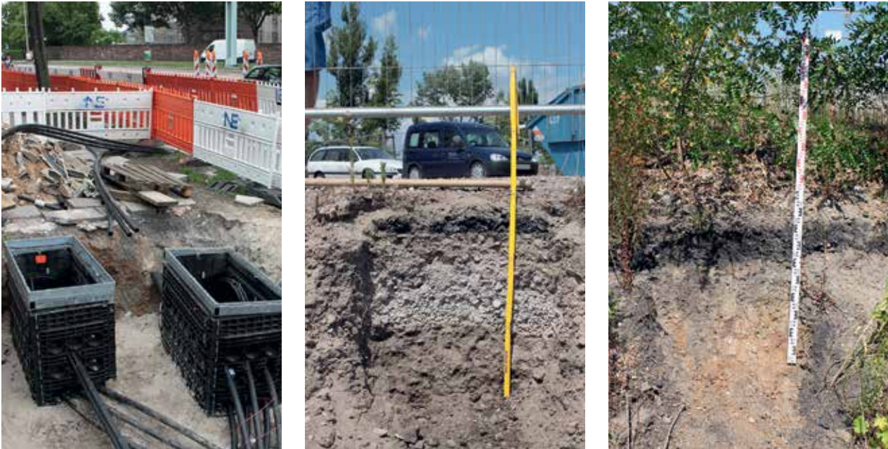
ABBILDUNG 3.5–2 ▶ Städtebau vernichtet natürlich gewachsene Böden und neue Böden bilden sich aus umgelagerten und technogenen Materialien. Links: Bodenarbeiten für eine Kabelverlegung. Mitte: Boden unter einer Straße mit grauer Zementschicht. Rechts: Schlackeschicht (schwarz) im Boden eines ehemaligen Rangierbahnhofs. (Fotos: aus Karlsruhe, Stefan Norra)
